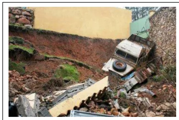
Glissement de terrain Vinon-sur-Verdon, rue des Pontis – 18/12/2008 – La Provence
