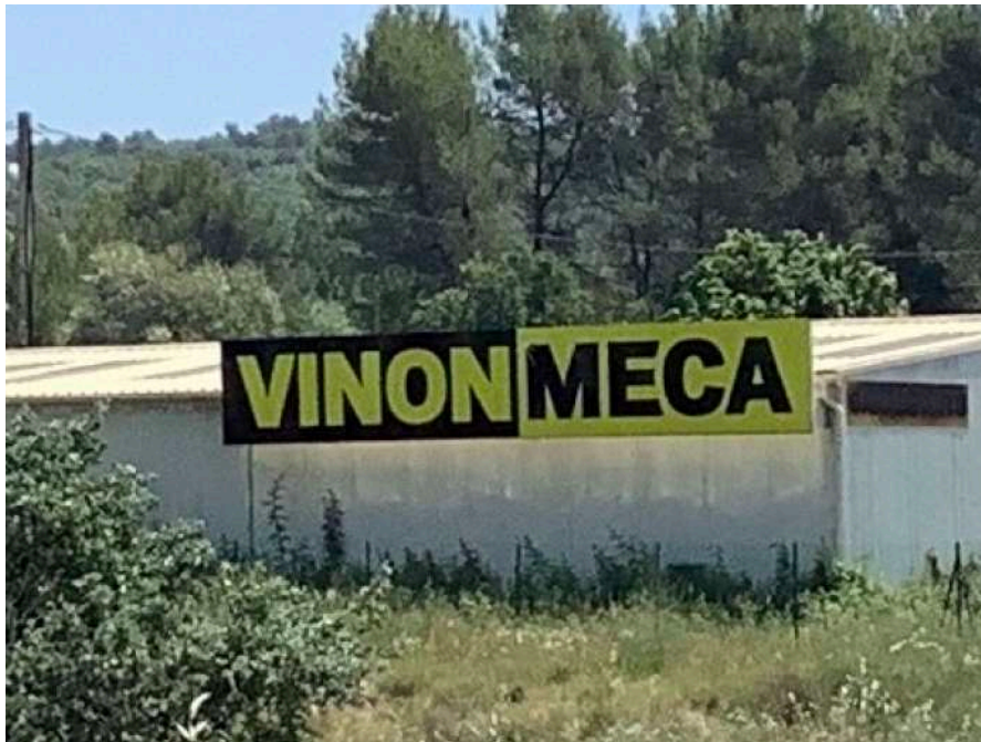
Enseigne parallèle au mur dépassant les limites du mur et de l'égout du toit, Vinon-sur-Verdon, juin 2022.
